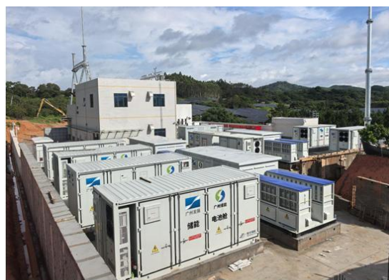
图：惠东梁化新能源配储项目。
